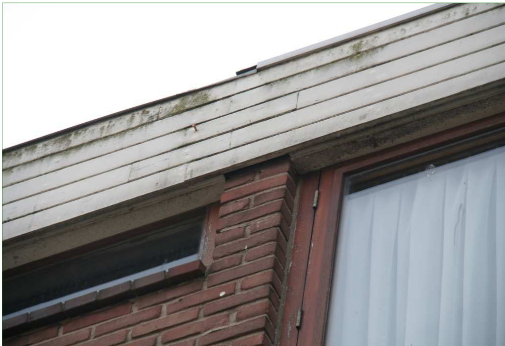
Gat tussen houtbetimmering en stenen muur.
